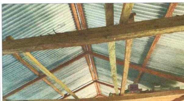
Fotografía 3: Se observa el deterioro de la estructura de techo de madera, se sustituirá por estructura de metal.
