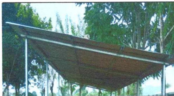
Fotografía 4: Se observa la necesidad de reparar el área de comedor de los estudiantes, ya que en el centro educativo se brinda la alimentación servida.
