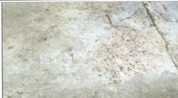
Fotografía 2: Se observa el deterioro de la torta de concreto por lo que se reparará la torta de concreto por piso cerámico.
