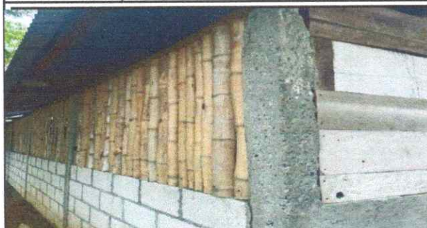
Fotografía 1: Se observa la necesidad de culminar las paredes de block.
